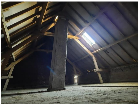
Figuur 5.20. Impressie van één zijde van de zolder van de schuur aangelegd aan het woonhuis.
