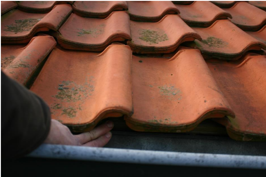
Figuur 4.4.2. Huismussen hebben geen toegang tot het dak door een te kleine opening onder de dakpannen.
