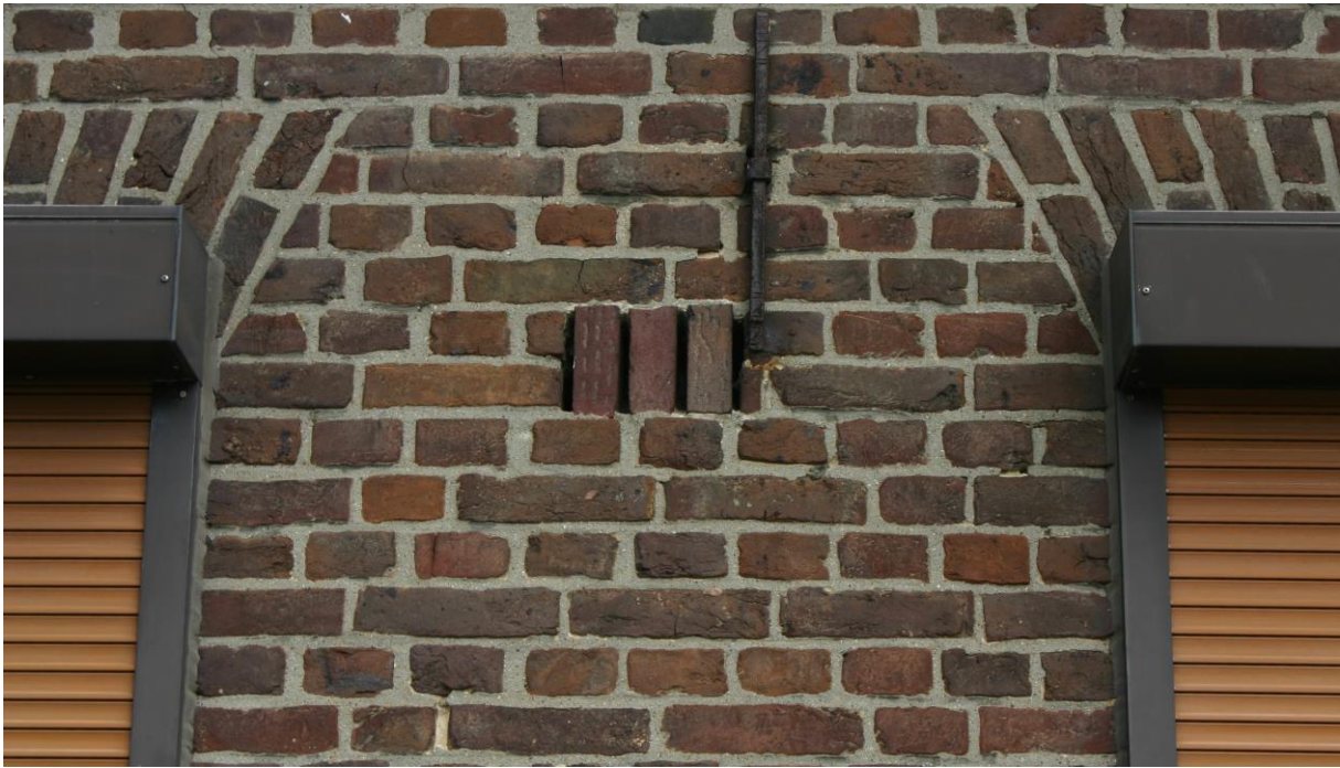
Figuur 4.2.3. Via ventilatie-openingen kunnen vleermuizen de woning binnen.
