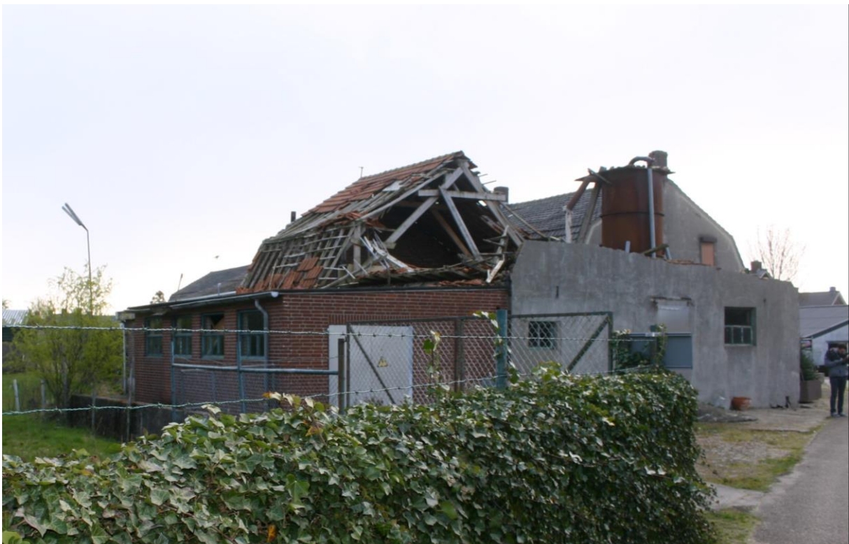
Figuur 4.1.3. Deels ingestort gebouw.
