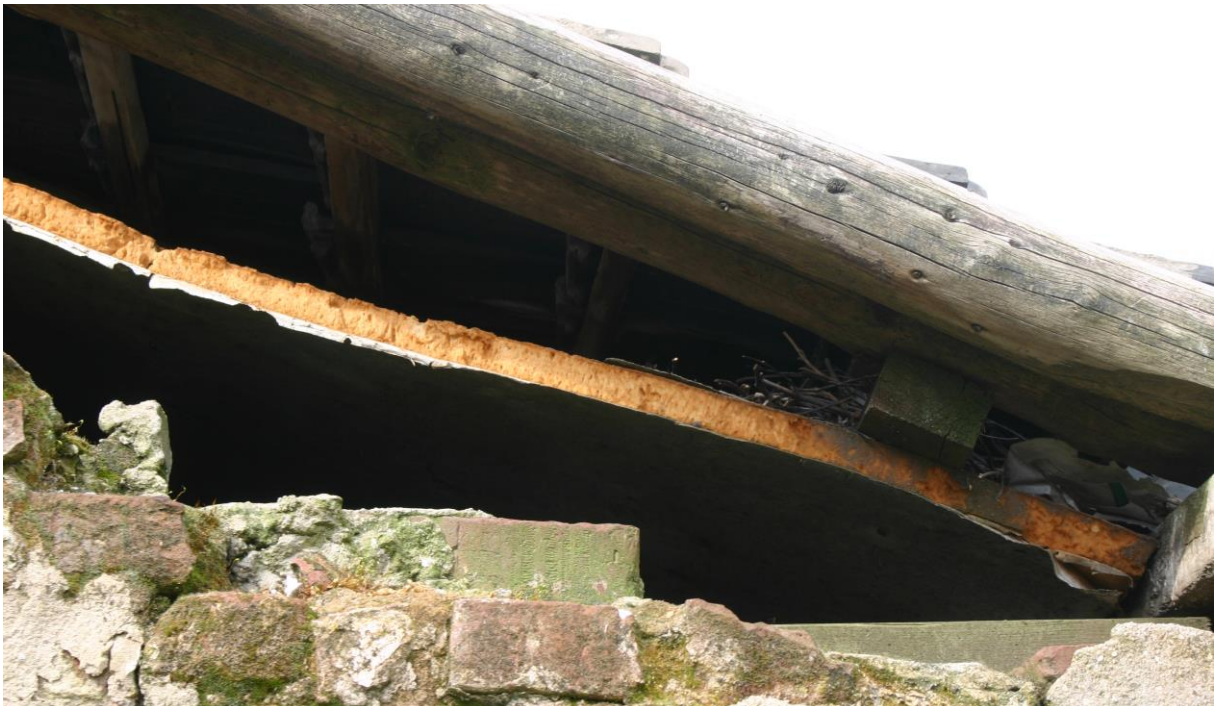
Figuur 4.2.4. De ruimte tussen het plafond en de dakpannen van de extra paardenstal is zeer ruim en daardoor te tochtig voor vleermuizen.
