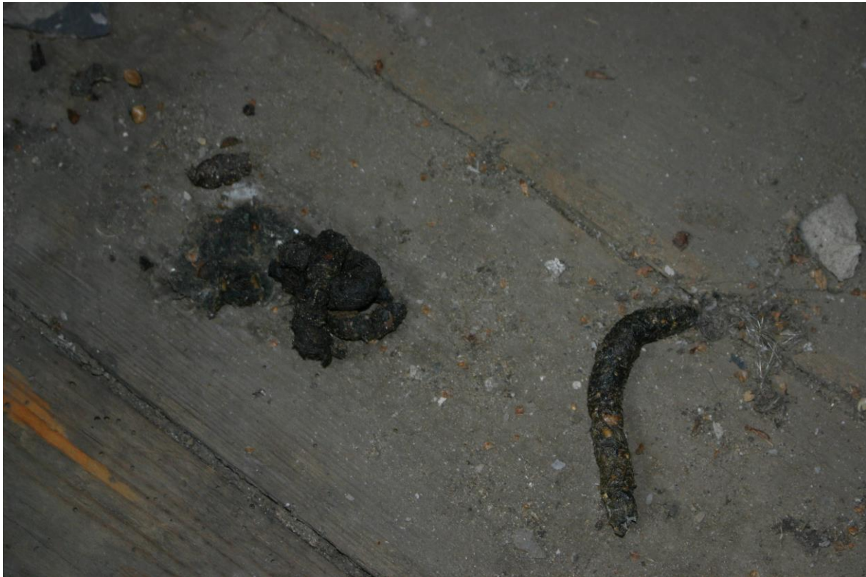
Figuur 4.2.5. Uitwerpselen van een steenmarter in het hoofdgebouw.
