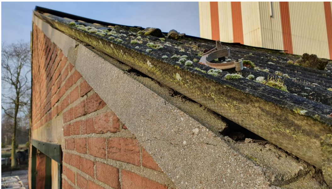
Figuur 4.4.2. Tussen de kopgevels en de golfplaten zijn kieren en spleten aanwezig waardoor vleermuizen de spouw kunnen bereiken. De meest zuidwestelijke kopgevel (hier afgebeeld) bevat de grootste spleten.
