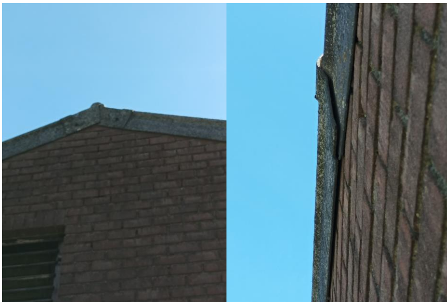
Figuur 4.2.2. De kopgevels met windveer en enkele kleine kieren.
