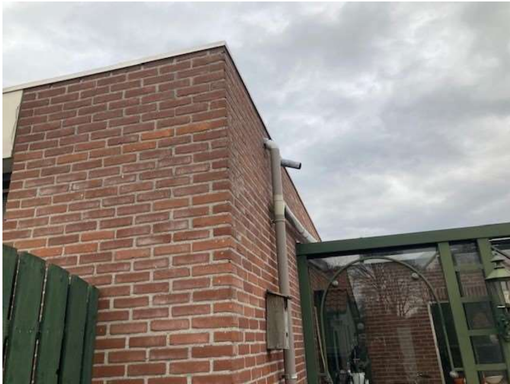
• Afbeelding 10: Gevel bedrijfsgebouw aluminium hoekstrip van plat dak
