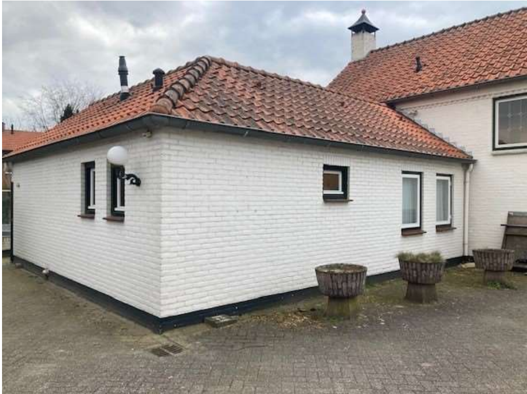
• Afbeelding 6: Aangebouwd bijgebouw nokvorsten ook dichtgesmeerd met cement
