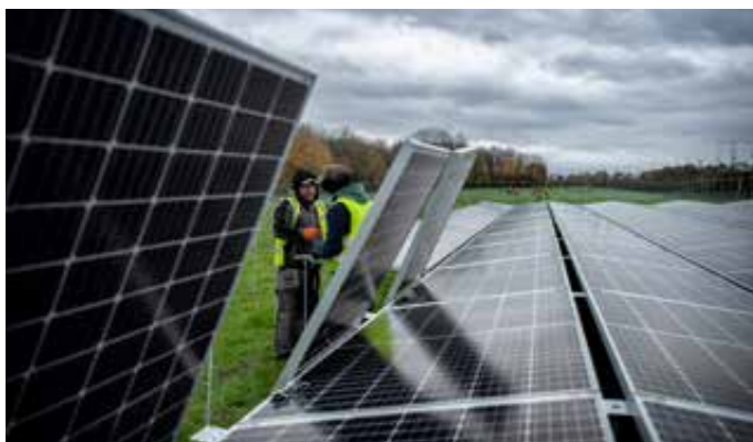
7. Zonnepark Spiesberg energiecoöperatie Peel Energie
