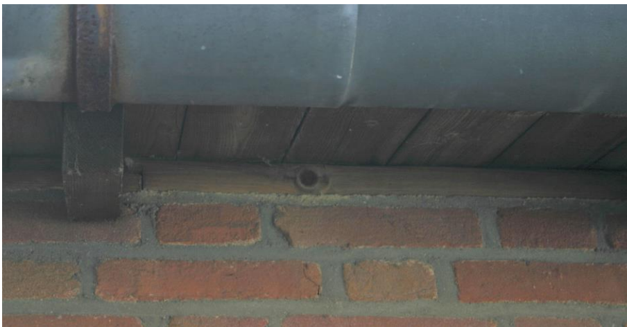
Figuur 4.4.5. Een muurplaat op de lange gevels voorkomt voor vleermuizen toegang tot de spouw.
