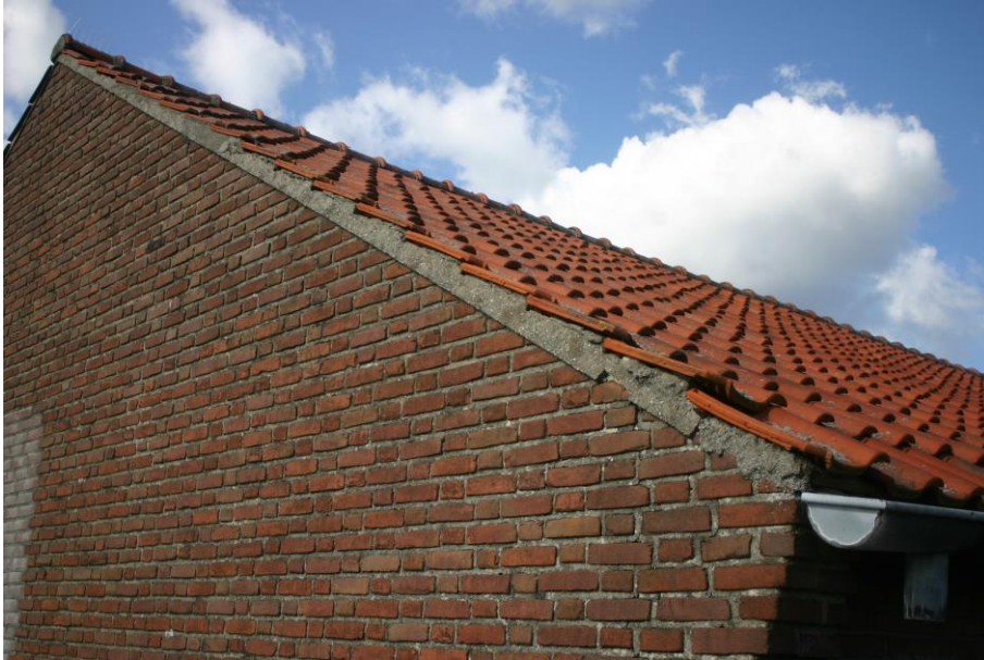
Figuur 4.4.1. De gevelpannen liggen in de specie, waardoor huismussen, gierzwaluwen en vleermuizen hier geen toegang hebben.
