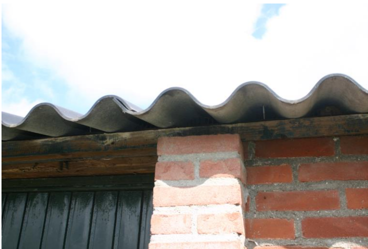
Figuur 4.2.2. De garage met golfplaten dak inclusief vogelschroot aan de onderkant.
